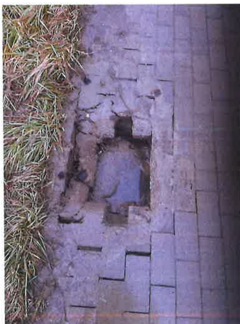
Zdjęcie nr 28 – Awaria kolektora kanalizacji ciśnieniowej w miejscowości Chruściele. Źródło: Archiwum własne
