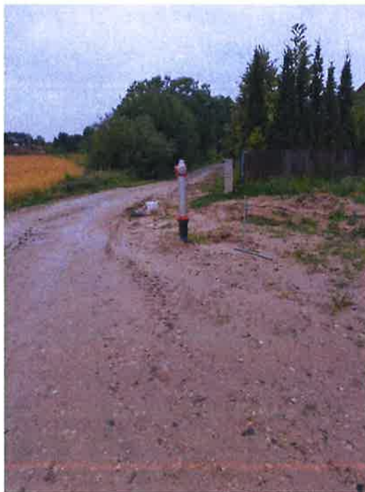
Zdjęcie nr 7 – Inwestycja budowy sieci wod.-kan. w miejscowości Bartosze dz. 69. Źródło: Archiwum własne
