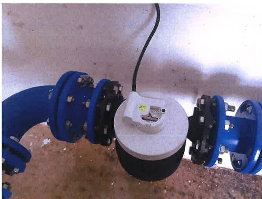
Zdjęcie nr 18 – Zamontowane urządzenia pomiarowe do zdalnego odczytu w miejscowości Nowa Wieś Etcka.
