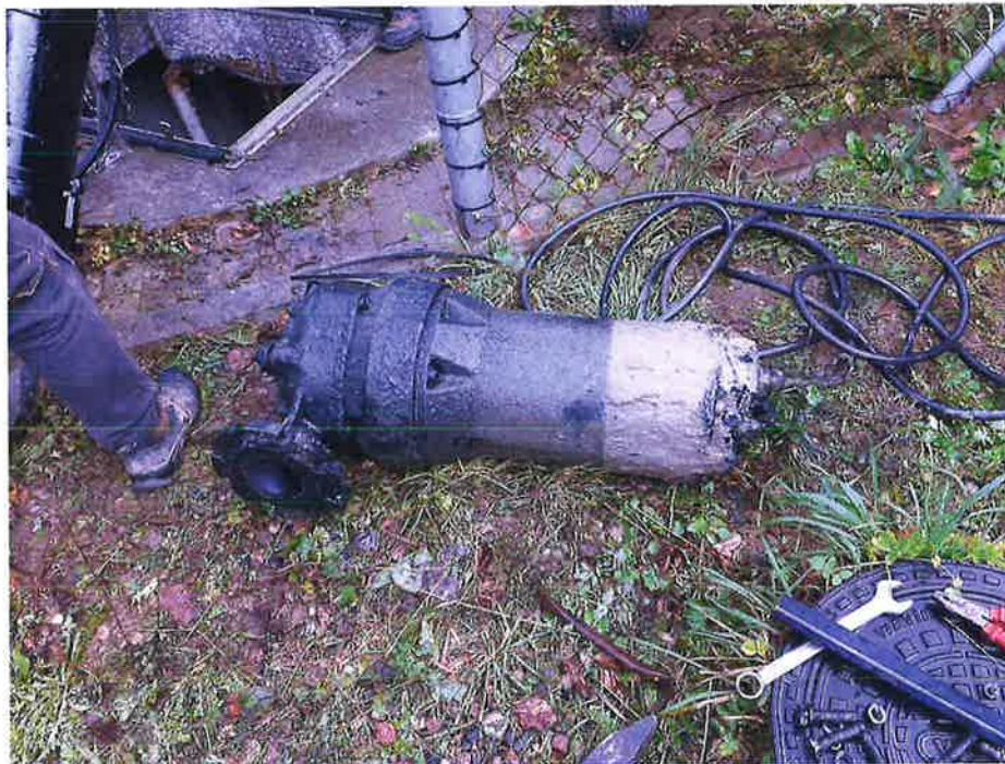
Zdjęcie nr 23 – Wymiana pomp w przepompowni ścieków w Bartoszach. Źródło: Archiwum własne
