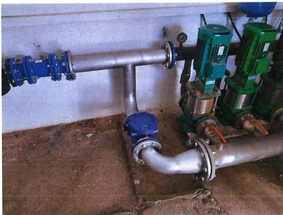
Zdjęcie nr 12– Modernizacja Stacji Podnoszenia Ciśnienia w Nowej Wsi Etckiej. Źródło: Archiwum własne
