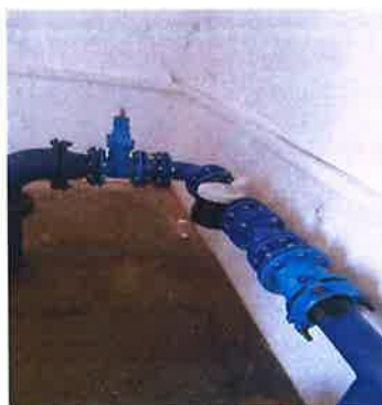
Zdjęcie nr 16 – Montaż urządzenia pomiarowego w Stacji podnoszenia ciśnienia w Nowej Wsi Ełckiej. Źródło: Archiwum własne
