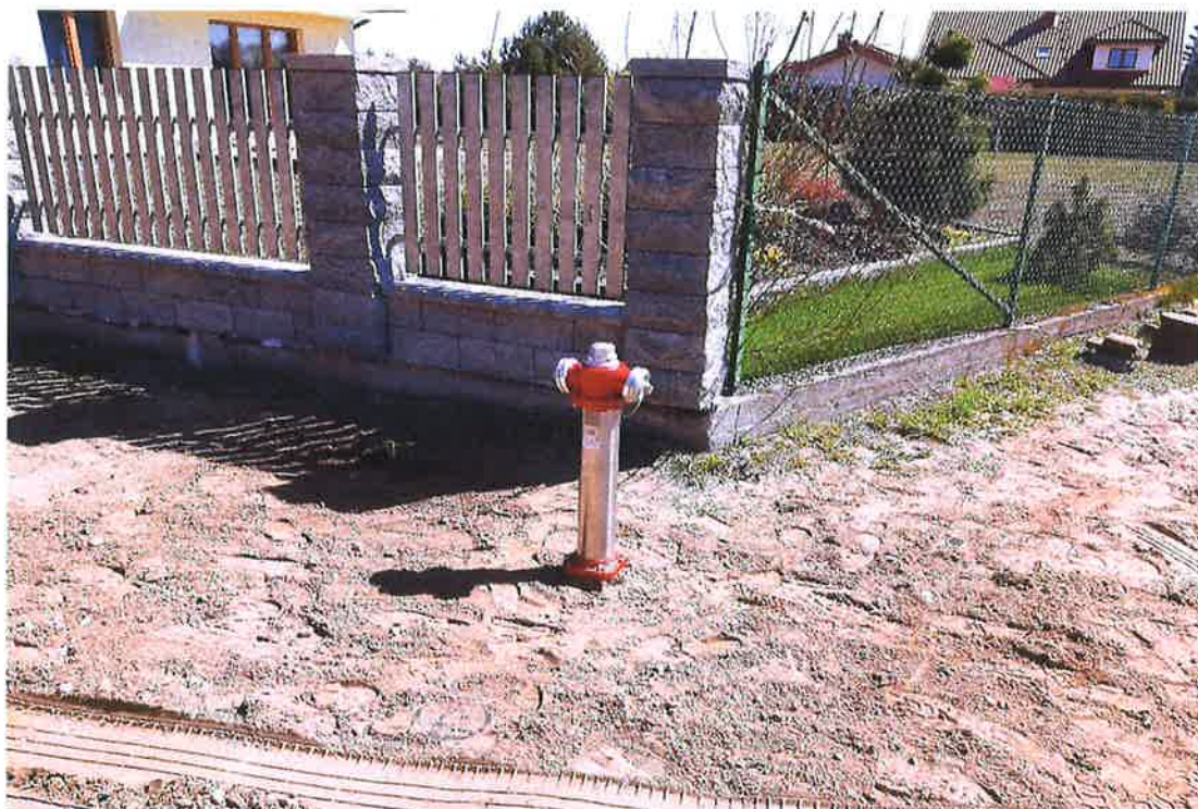
Zdjęcie nr 6 – Inwestycja budowy sieci wod.-kan. w miejscowości Barany- Chruściele. Źródło: Archiwum własne
