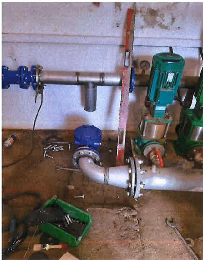
Zdjęcie nr 11– Modernizacja Stacji Podnoszenia Ciśnienia w Nowej Wsi Ełckiej. Źródło: Archiwum własne
