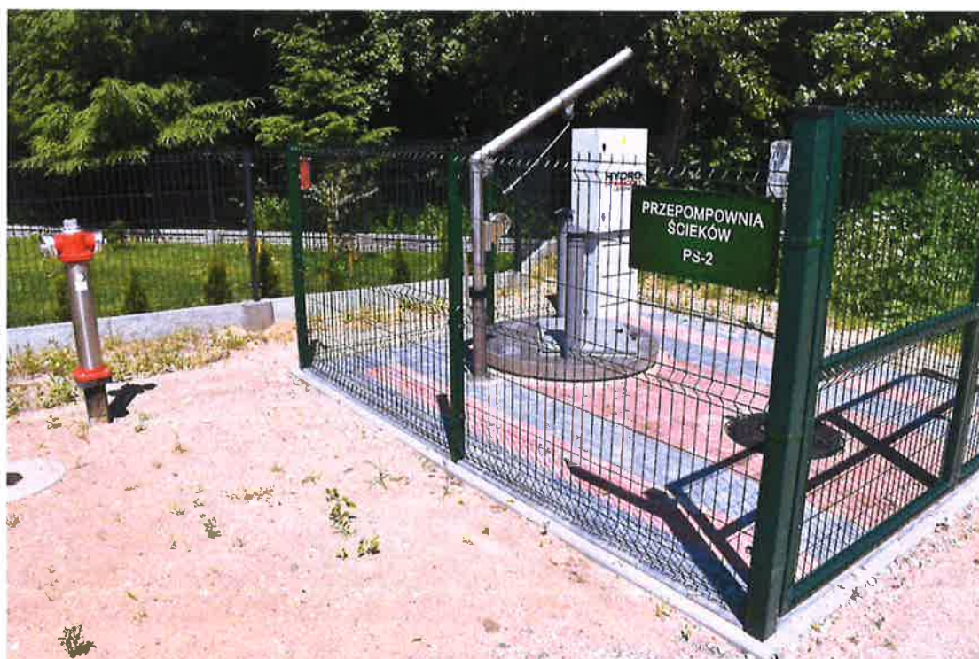
Zdjęcie nr 3 – Inwestycja budowy sieci wod.-kan. w miejscowości Barany- Chruściele. Źródło: Archiwum własne
