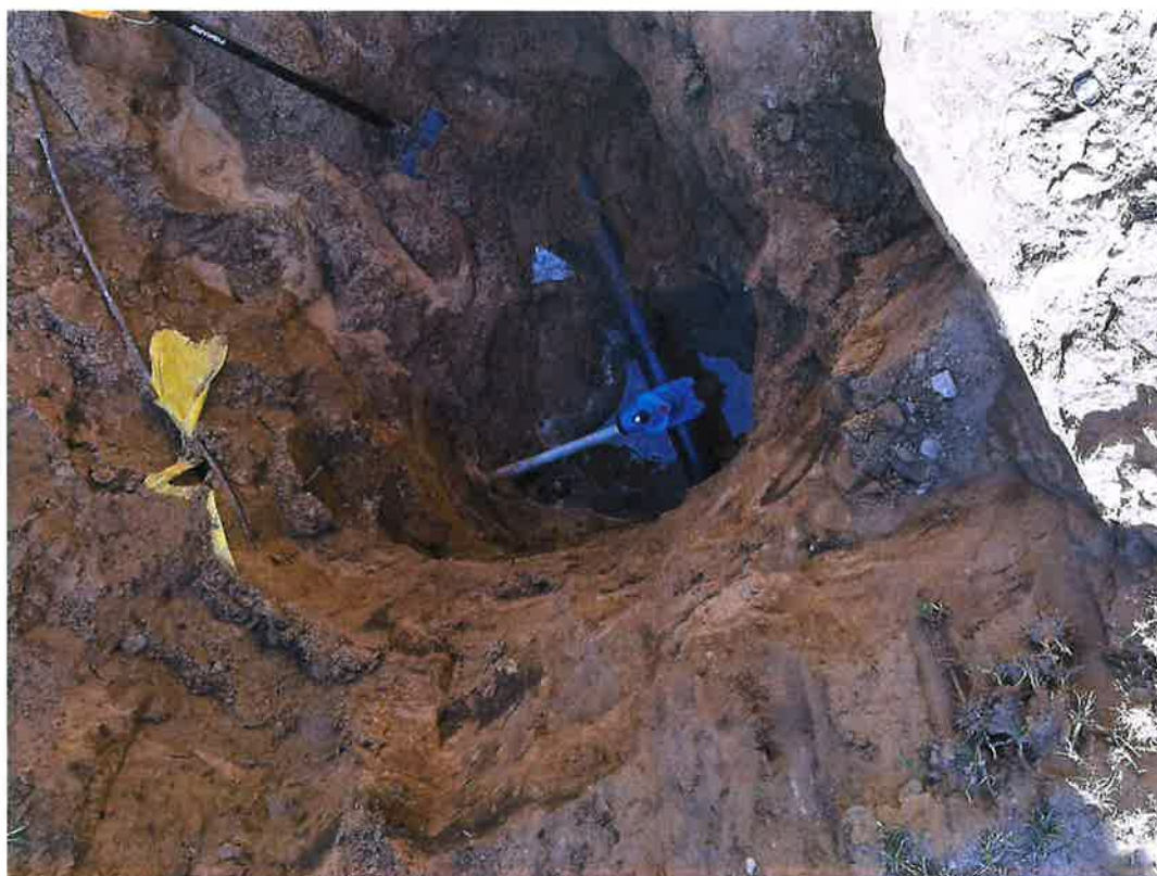
Zdjęcie nr 30– Awaria na sieci wodociągowej na ul. Szkolnej w miejscowości Straduny. Źródło: Archiwum własne
