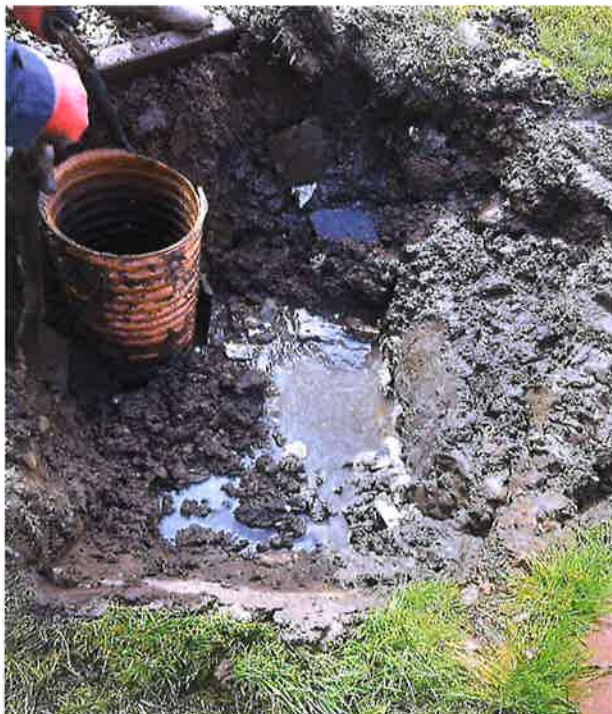
Zdjęcie nr 29 – Awaria kolektora kanalizacji grawitacyjnej w miejscowości Sędki. Źródło: Archiwum własne
