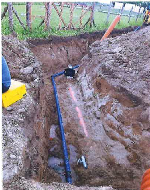
Zdjęcie nr 35– Budowa sieci wodno-kanalizacyjnej w miejscowości Bartosze dz. 53/12. Źródło: Archiwum własne
