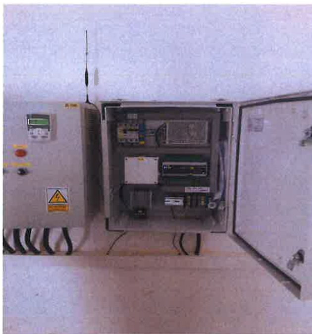
Zdjęcie nr 17 – Zamontowane urządzenia pomiarowe do zdalnego odczytu w miejscowości Nowa Wieś Etcka.
