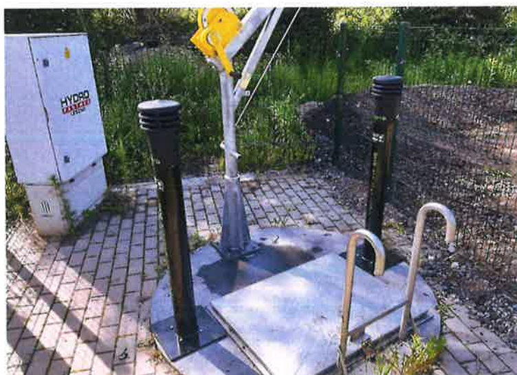
Zdjęcie nr 20 – Montaż filtrów antyodorowych na przepompowni ścieków w miejscowości Sędki. Źródło: Archiwum własne
