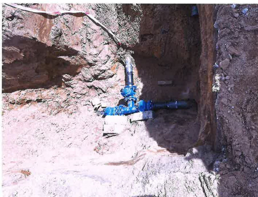
Zdjęcie nr 4 – Inwestycja budowy sieci wod.-kan. w miejscowościach Barany - Chruściele (Archiwum ZUG)
