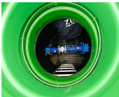
Rys. nr 1. Komora pomiarowa
