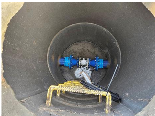
Rys. nr 2 Komora pomiarowa Siedliska
