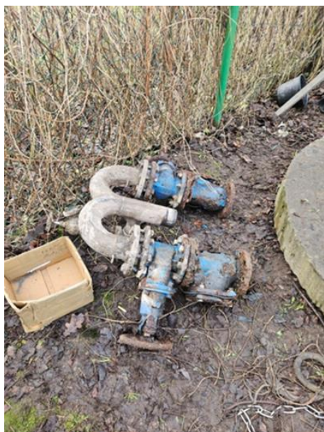
Rys. nr 5 Przepompownia Chełchy stare urządzenia.
