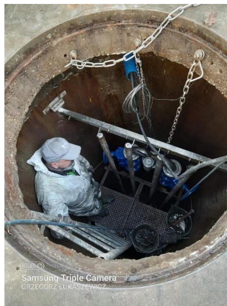
Rys. nr 6 przepompownia Chełchy po modernizacji
